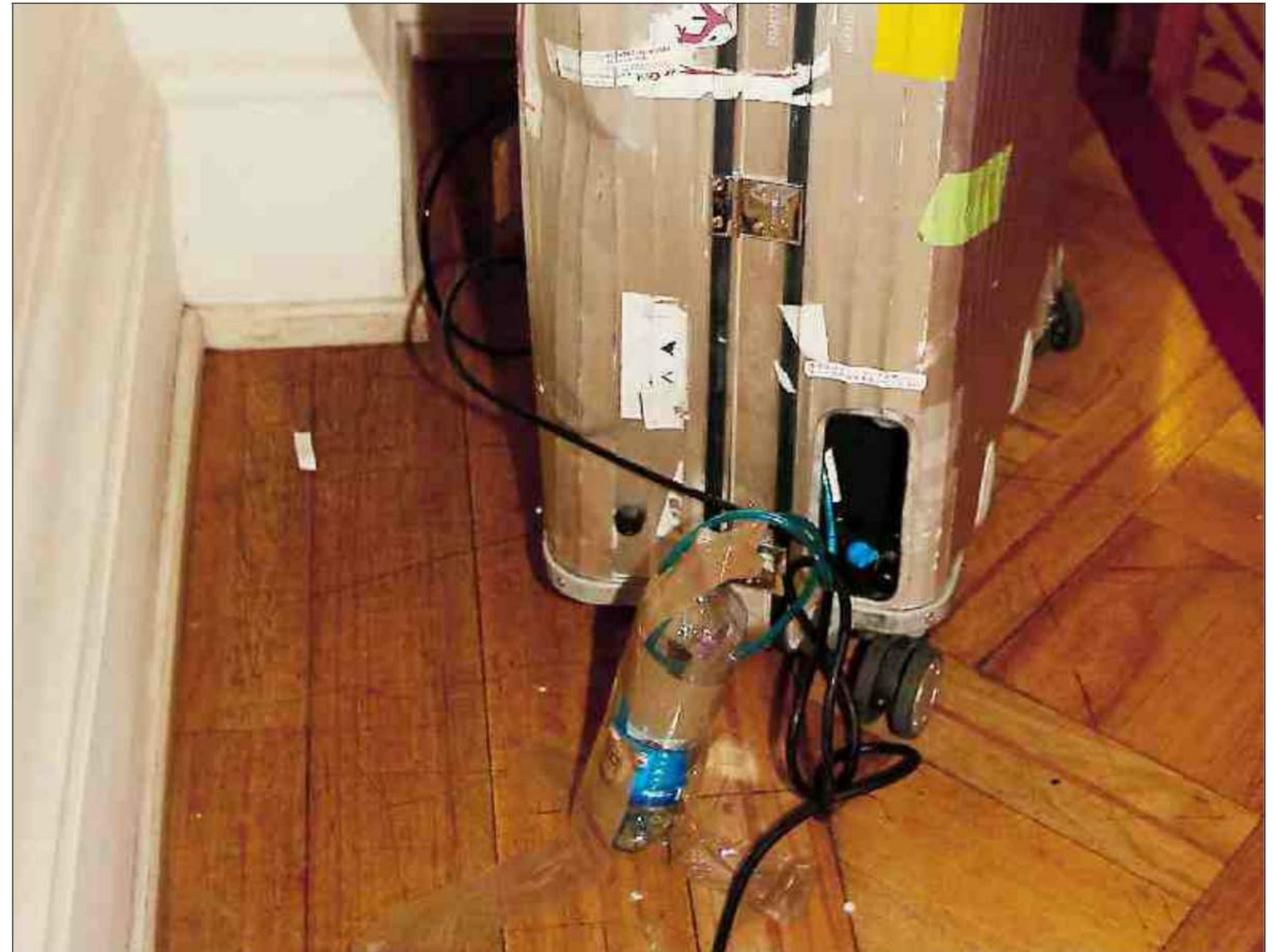
La maleta contiene el compresor y estaba instalada en uno de los pasillos.
